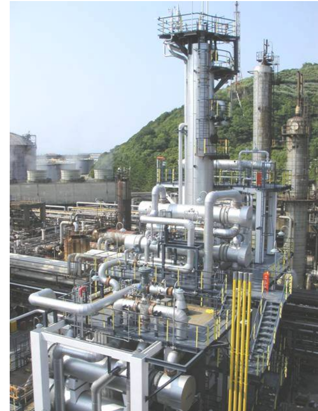
和歌山に新設した 超低硫黄燃料油製造装置
